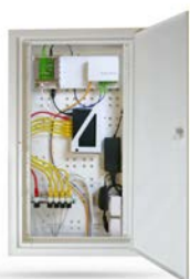
QDSA5TS QDSA - Quadro di Distribuzione Segnali Appartamento
